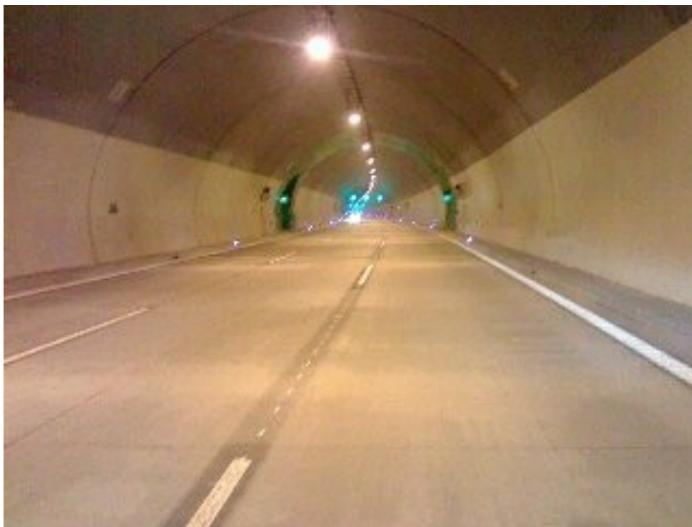
Obrázek 9 - Použití vodících trvale svítících knoflíků v tunelu
